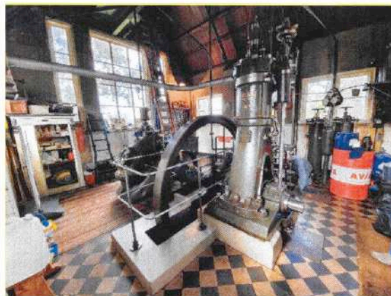
Rechts: interieur dieselmool. Van links naar rechts de centrifugaalpomp, een vliegwiel en de dieselmotor.
